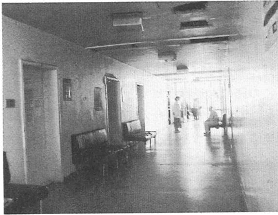
照明も切れたままの院内
