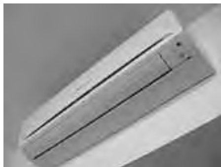
↗ (エアコンは冷暖房兼用のタイプ)
